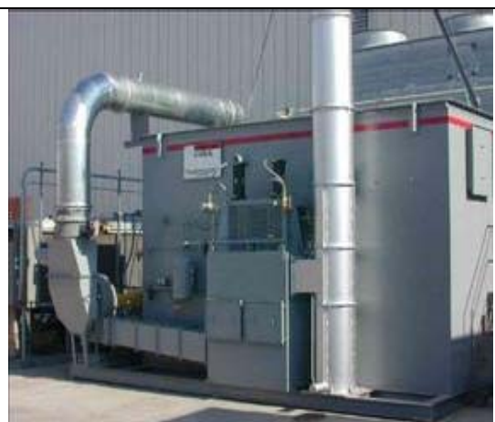
某化工 RTO 蓄热式焚烧炉项目
