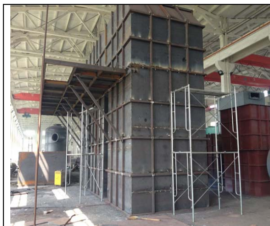
上海化工园 RTO 蓄热焚烧项目
